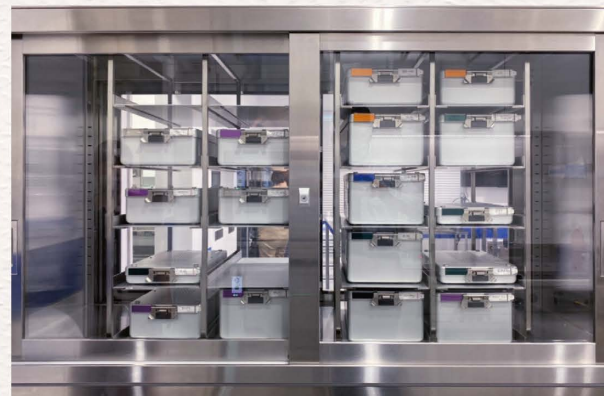
オペ室と滅菌・消毒室の間に設置されたバスルーの滅菌保管庫
